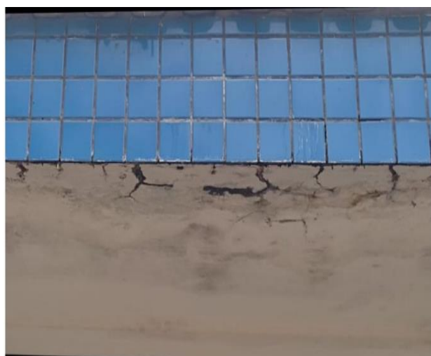
Figura 1 – Fissuras longitudinais no forro do corredor.
