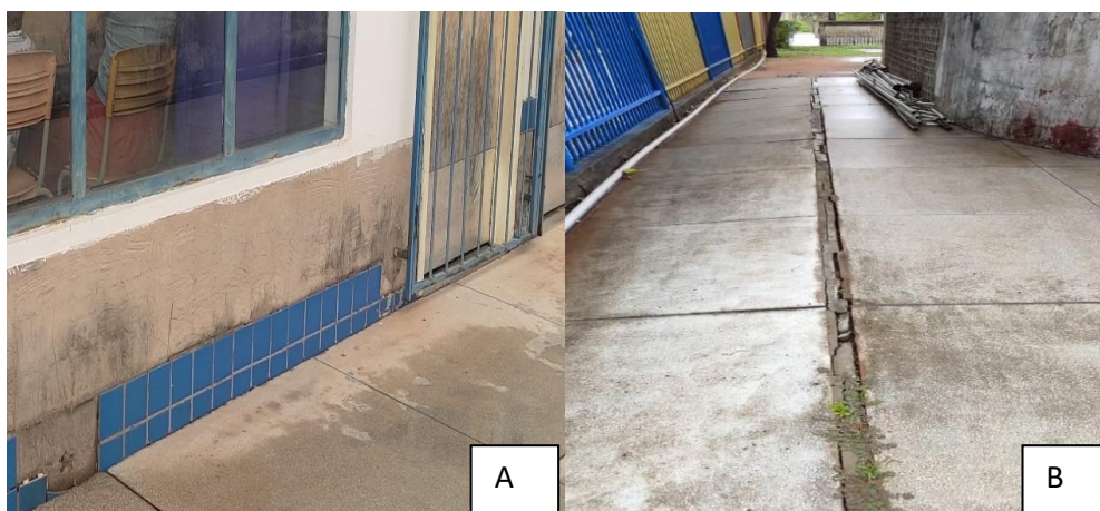
Figura 4 – A – deslocamento de placas cerâmicas, B- fissuras.
