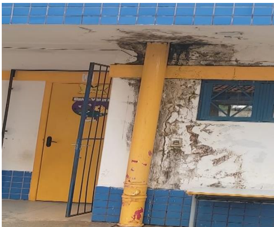
Figura 2 – Manchas de infiltração localizadas no forro e parede do corredor.
