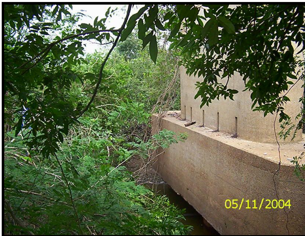
Figura 6 - Ação de plantas e raízes sobre bloco de coroamento de pilar que compõe a ponte do rio Tocantins, no Pará, Brasil.
