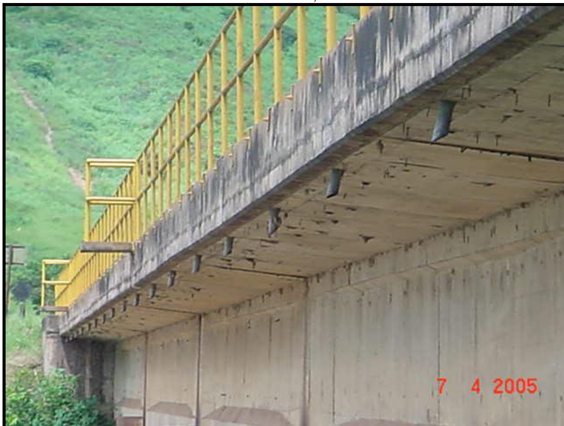
Figura 8 - Ralos de drenagem compondo o sistema de impermeabilização do tabuleiro da ponte sobre o rio Doce, Brasil.
