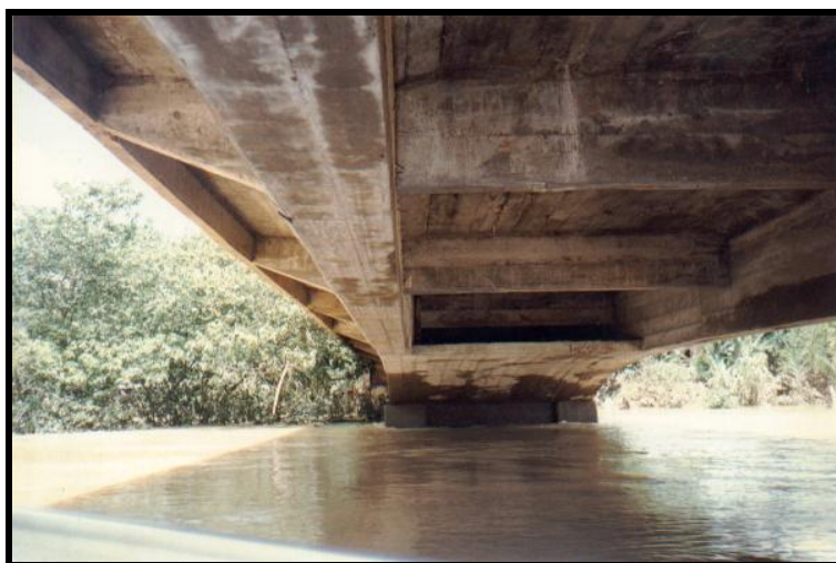
Figura 1 - Infiltrações e anomalias como de lixiviação e eflorescências carbonáticas no concreto, com exposição das armaduras à corrosão, na ponte sobre o rio Muriaé, Rio de Janeiro, Brasil.
