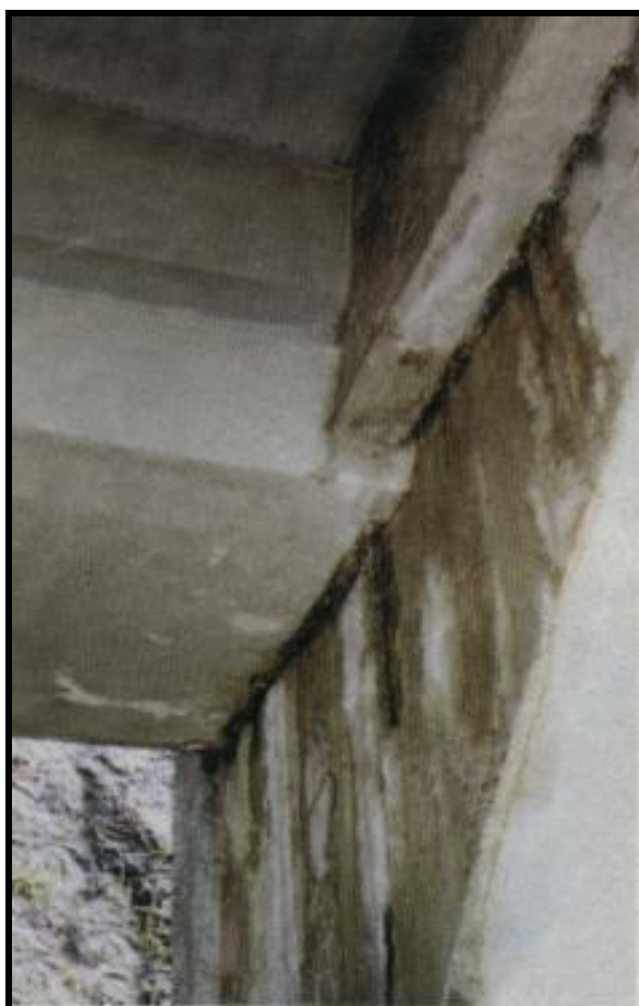
Figura 5 - Interface tabuleiro e pilar do elevador do Joá apresentando infiltração pela junta estrutural e anomalias no concreto.
