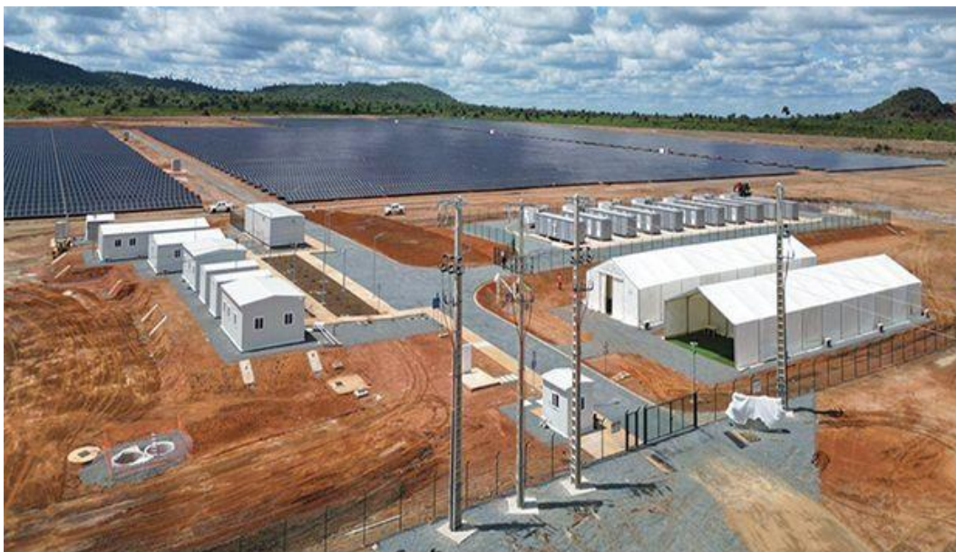
Figura 4 - Parque solar fotovoltaico do Cazombo
