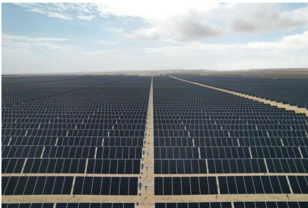
Figura 3 – Disposição dos módulos fotovoltaicos
