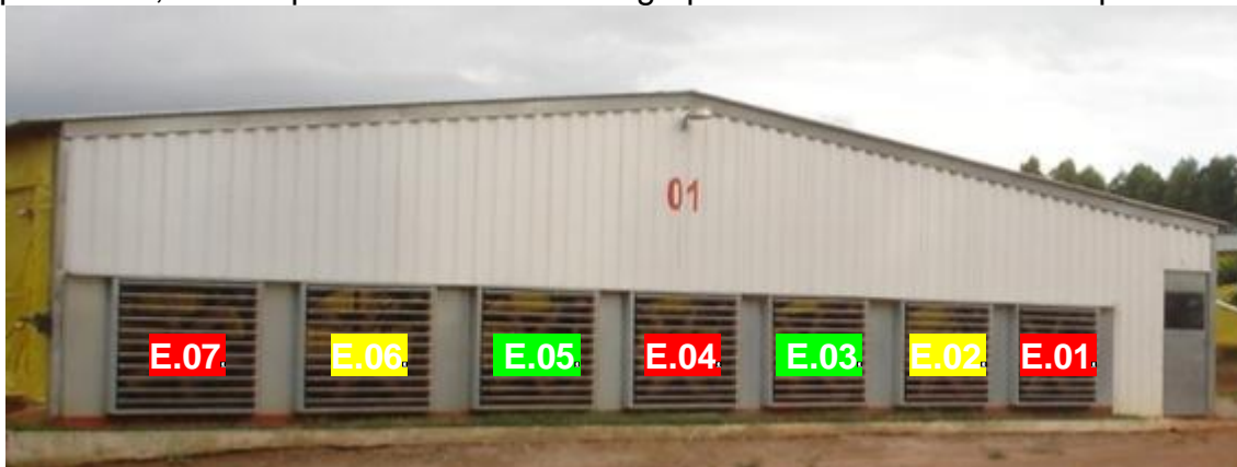
Figura 1 - Vista geral do sistema de ventilação (Exaustores E01 a E07)
